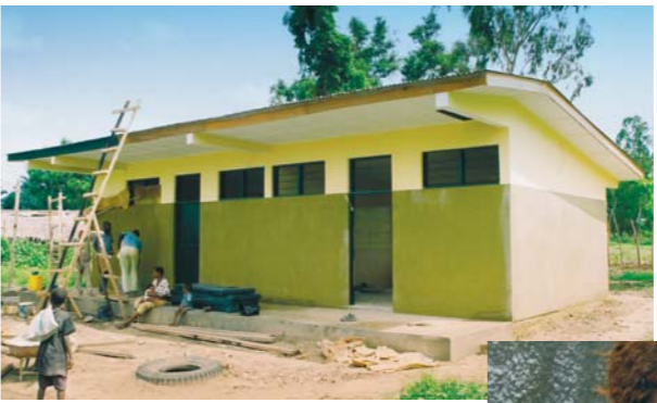
Das Haus mit sanitären Anlagen in N'sele in der DR Kongo.
